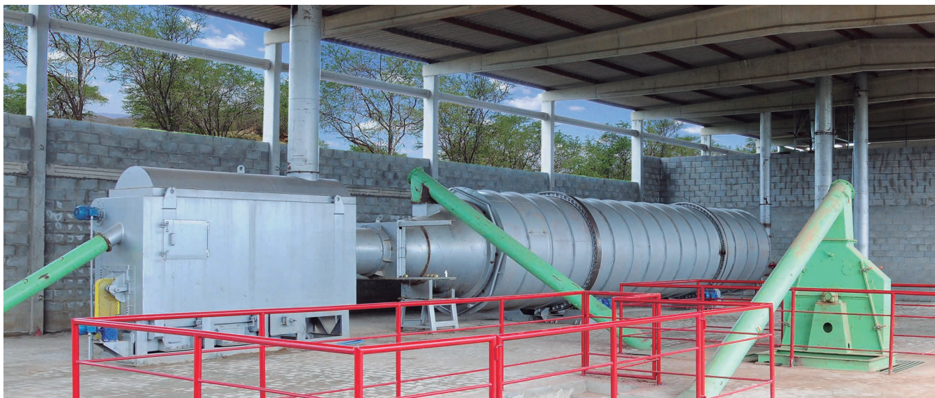
O secador rotativo retira a maior parte da umidade da biomassa para que ela possa ser prensada e transformada em briquete.
