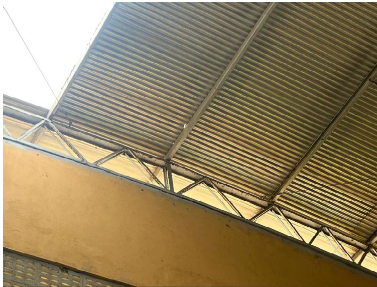
Foto 05 – Imagem interna do ginásio, pontos de oxidação no arco mais externo (viga metálica da fachada frontal) da estrutura metálica do ginásio.
