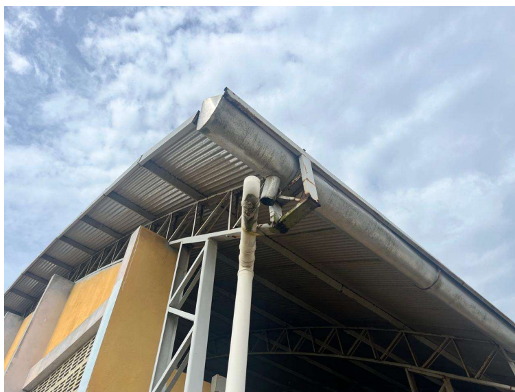
Foto 08 – Imagem externa do ginásio, desconexão da descida da Com a tubulação de drenagem.
