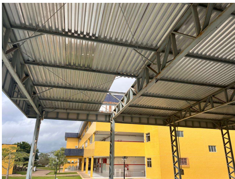
Foto 15 – Área de vivência, um dos locais que está sem a telha de alumínio (Início da Foto 13).
