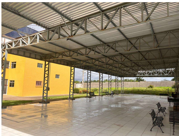
Foto 13 – Área de vivência (metade à esquerda), locais que estão sem telha de alumínio.
