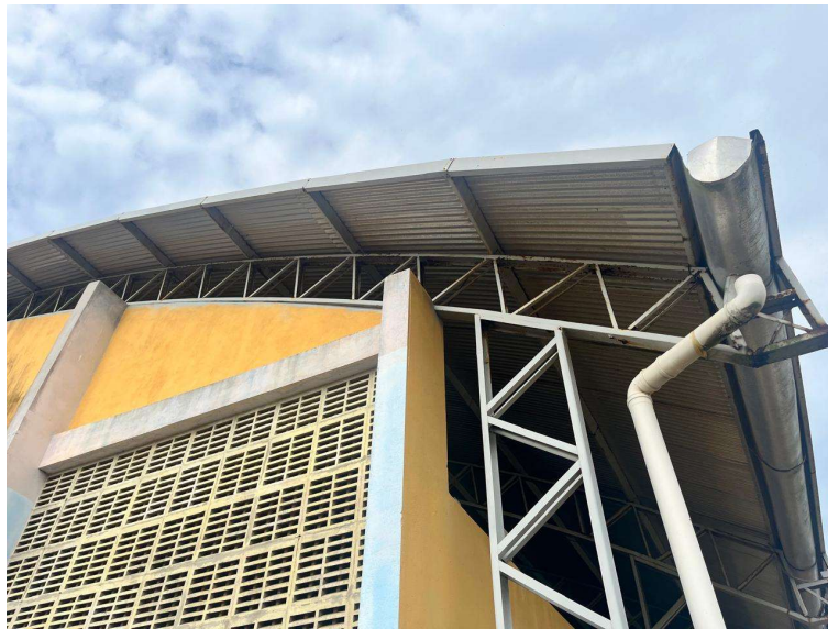
Foto 09 – Imagem externa do ginásio, arco mais externo, Localizado na fachada frontal do ginásio, com vários pontos De oxidação na estrutura metálica.
