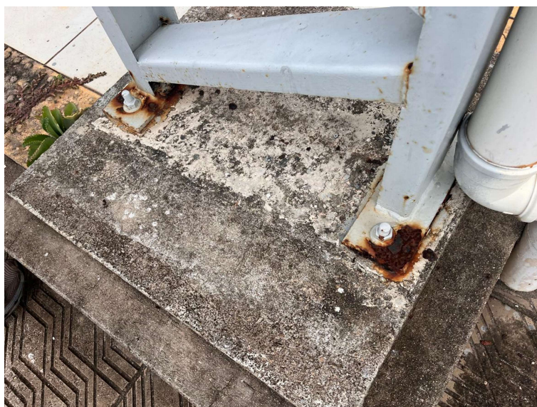
Foto 17 – Área de vivência, oxidação em base de pilar.
