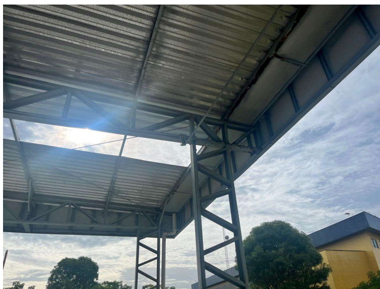
Foto 12 – Área de vivência, um dos locais que está sem a telha de alumínio.
