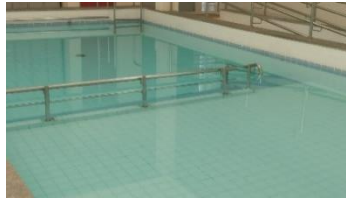
Figura 03 – Corrimão instalado na piscina da FACISA/UFRN Santa Cruz RN Fonte: Autores
