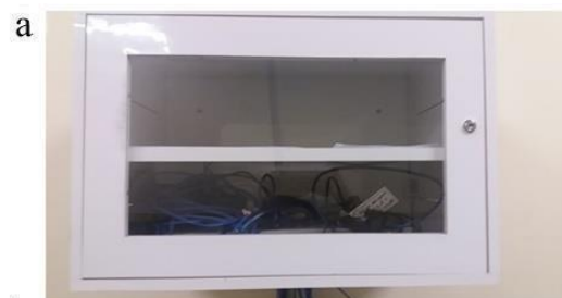
Figura 2 - (a) Rack de rede; (b) Sistema operacional Linux Educacional; (c) Proteção com cabo de aço nas máquinas.
