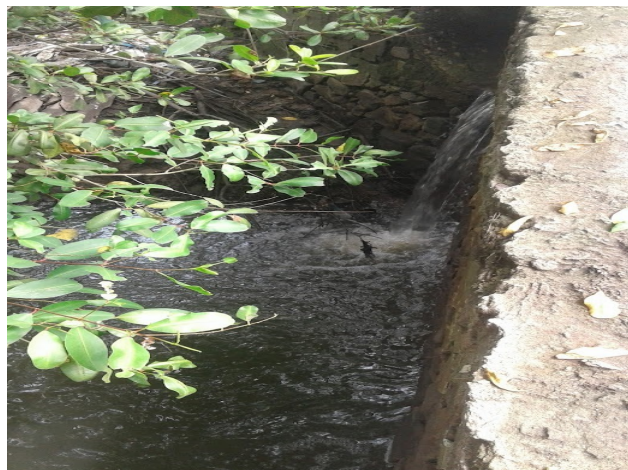
FIGURA 03: DESCARTE DO ESGOTO DENTRO DO RIO JUNDIAÍ MACAÍBA - RN
